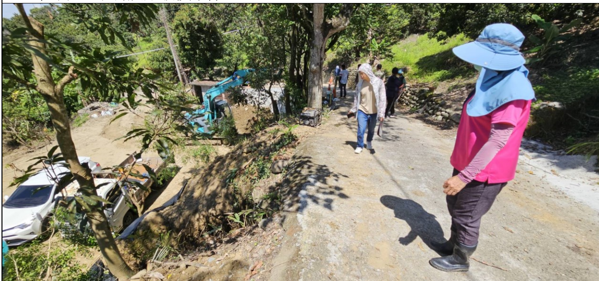
112年6月29日既有砌石護岸老舊及農路破損案件
