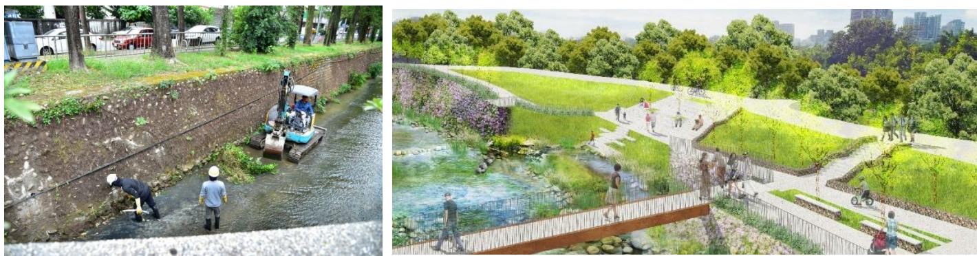
大智排水水環境改善整體計畫(仁和路至喬城路)施工中照片與 3D 模擬圖
