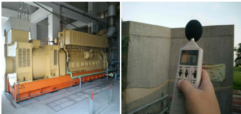
廠內原設置發電機體積大、效能差且運轉時噪音過大
