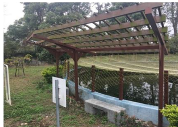
現況終沉池，水池面積大且牆墩低矮，有危險之疑慮，目前以圍網阻隔。
