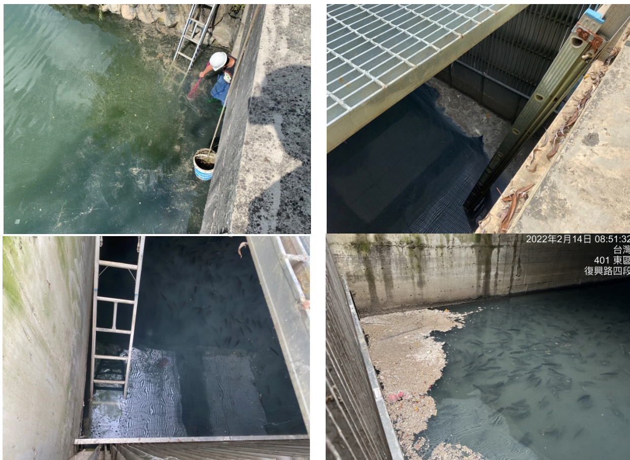
圖 13 星泉湖入水口及內部溝渠髒汙現況照片
